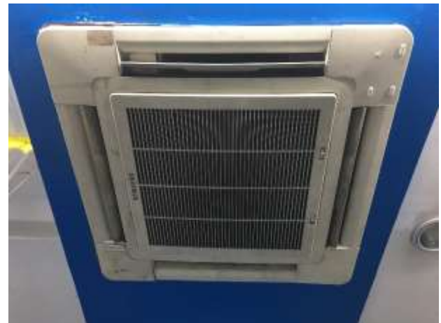
Fan Coil Unit
